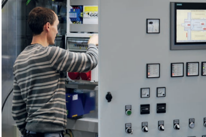
Teil des kompetenten Teams: Sergej Romaker beim Qualitätstest an einem neuen Schaltschrank
