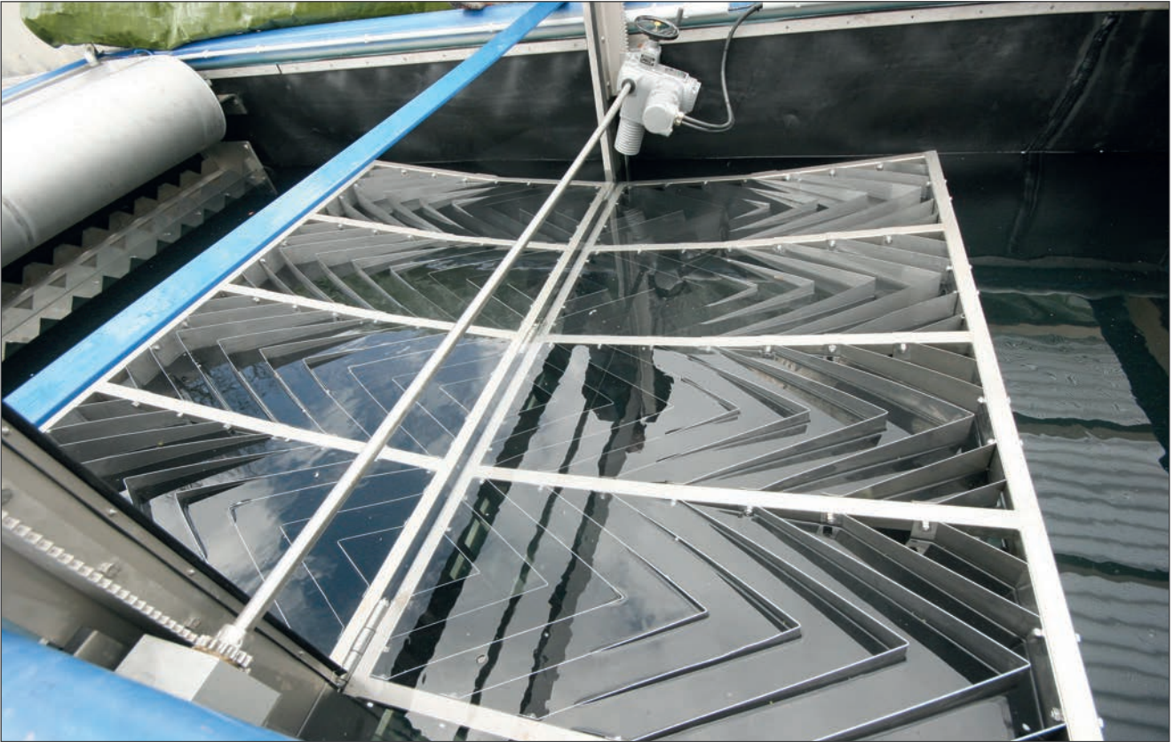
Blick von oben in den Container. Die Schrägklärermodule sind zur Abreinigung hochgeschwenkt.
