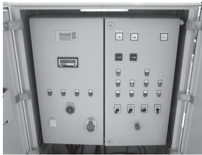
Bild 4: Bedien- und Anzeigeräte in der Schaltschrankfront (Freiluft-Schaltschrank)
