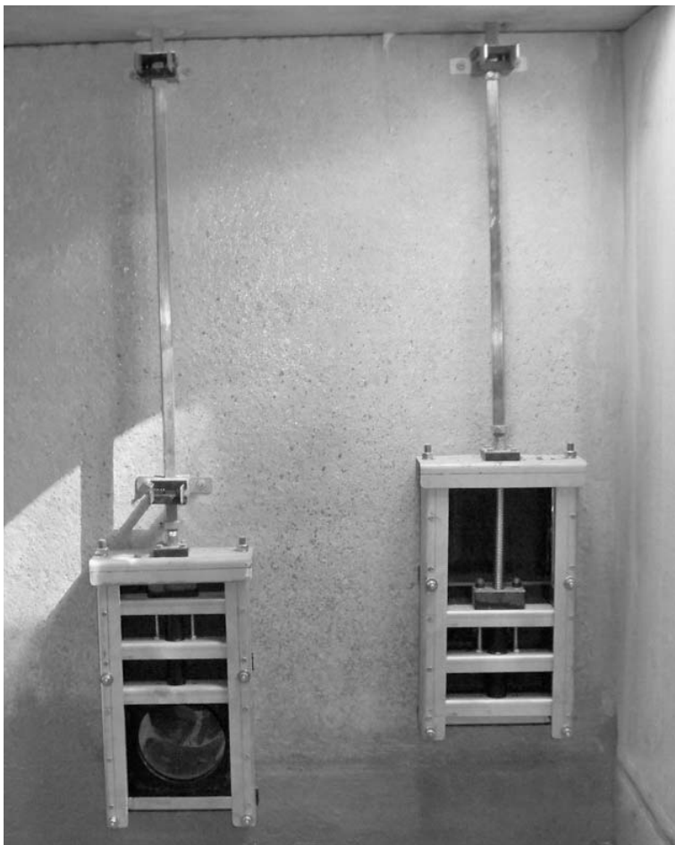
Bild 1: Frisch montierte Absperrschieber UFT-FluidKWT DN 200 vor der Drossel- bzw. Umlaufleitung im Auslassbauwerk eines Regenbeckens
