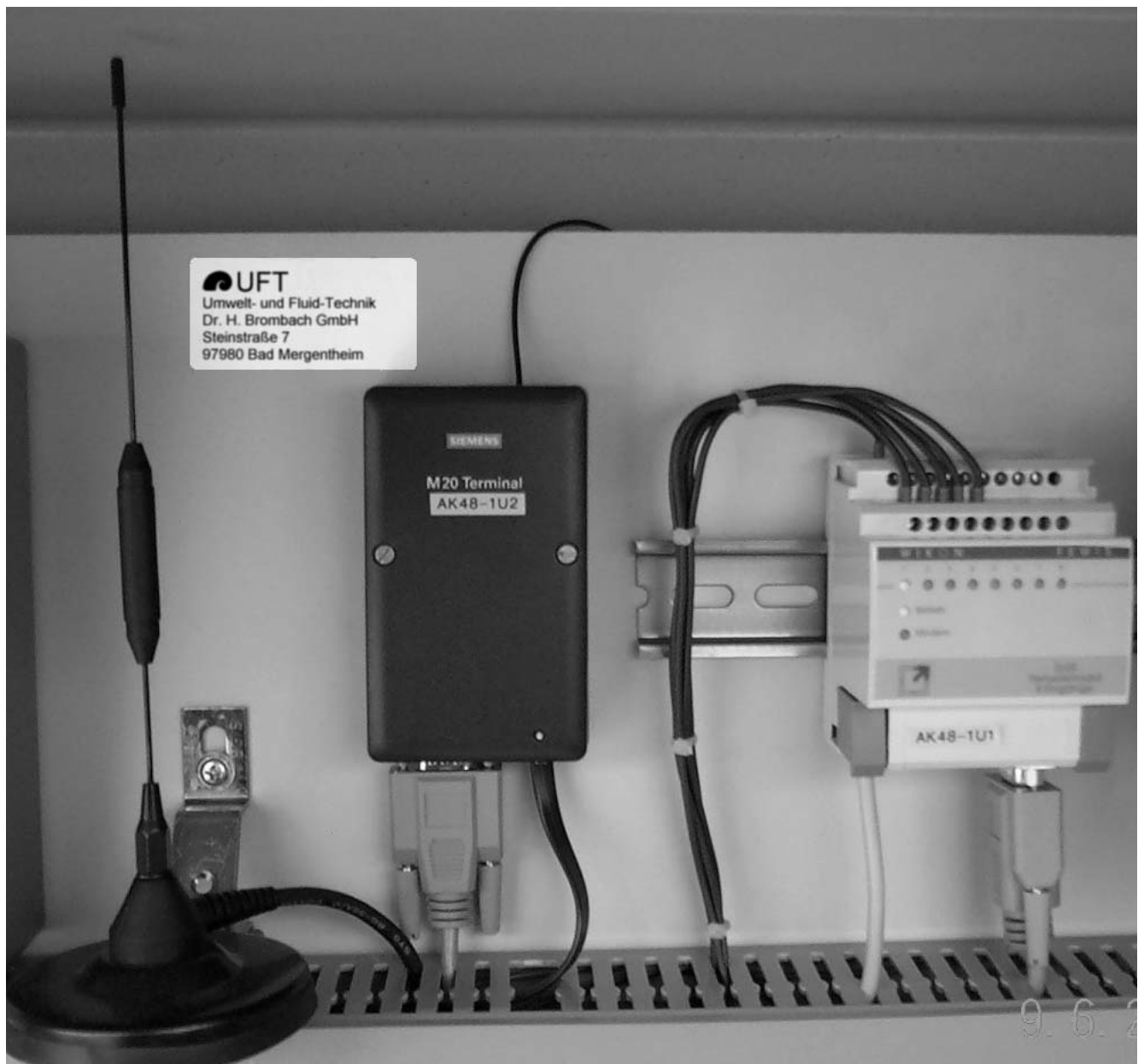
Störmeldesystem, bestehend aus Störmelder, Telefonmodem und Antenne (von rechts nach links)
