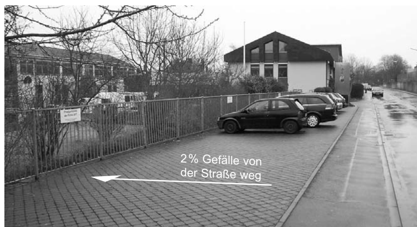
Bild 1: UFT-Parkplatz bei Regen, 18 Jahre nach Inbetriebnahme, Pflaster mit engen, nicht verfüllten Fugen auf einer Splittunterlage
