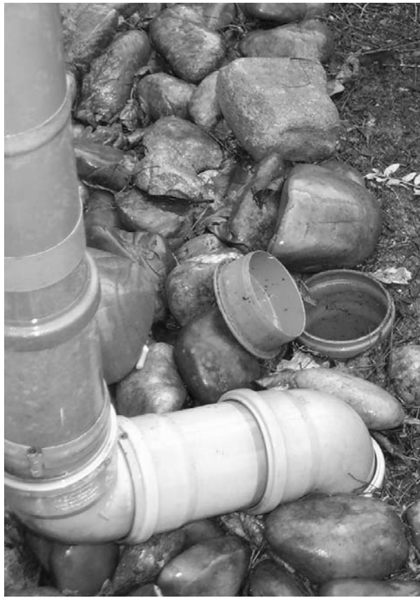
Bild 3: Dachablauf mit zwei Anschlüssen, Versickerung – Abwasserkanal. Bei Bedarf könnten die Fallrohre wieder an die Mischwasserkanalisation angeschlossen werden.
